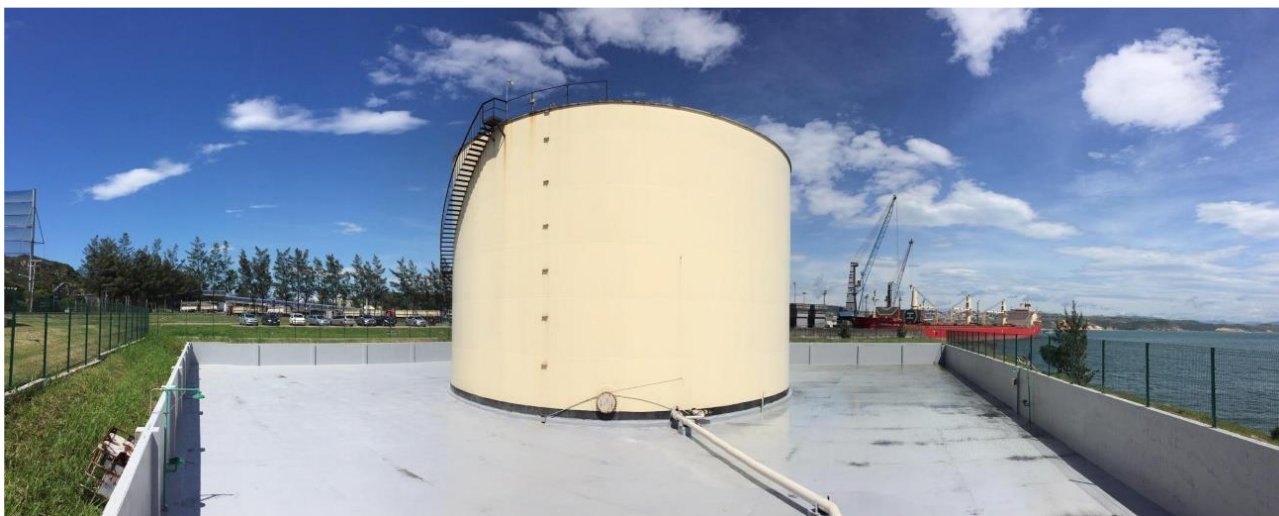
Figura 13: Bacia 1 com o tanque 1 Fonte: EVTEA doado NCA - 2020
